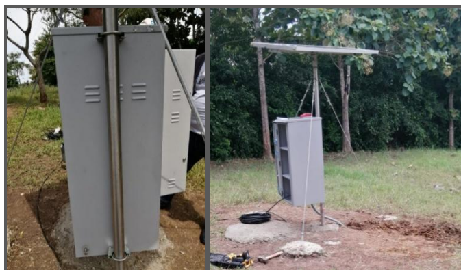
Figura 21. Instalación del Gabinete. Ilustración de trabajo conjunto SGC – IGAC
