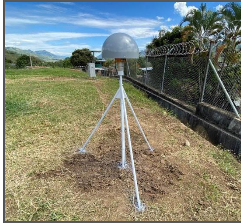
Figura 35. Antena GNSS instalada. Ilustración de trabajo conjunto SGC – IGAC.
