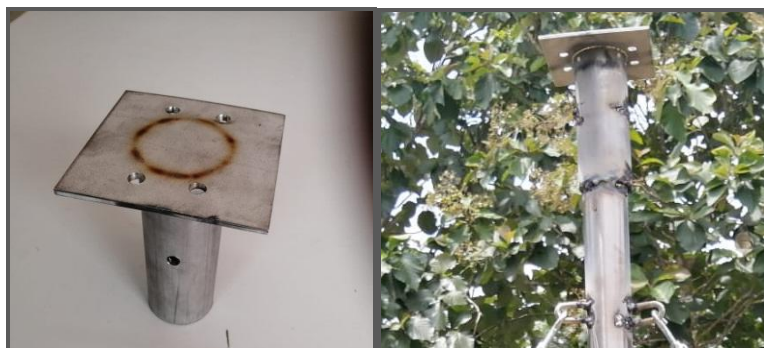
Figura 16. Base de sujeción de panel solar. Ilustración de trabajo conjunto SGC – IGAC.
