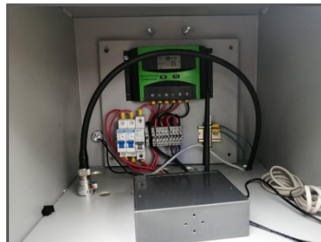
Figura 27. Instalación eléctrica. Ilustración de trabajo conjunto SGC – IGAC.
