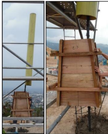
Figura 59. Hincado de la varilla de hierro con tubo PVC. Recuperado de: Elaboración propia.
