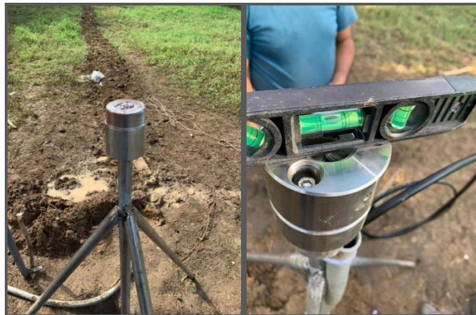
Figura 33. Instalación del adaptador y base nivelante para CORS. Ilustración de trabajo conjunto SGC – IGAC.
