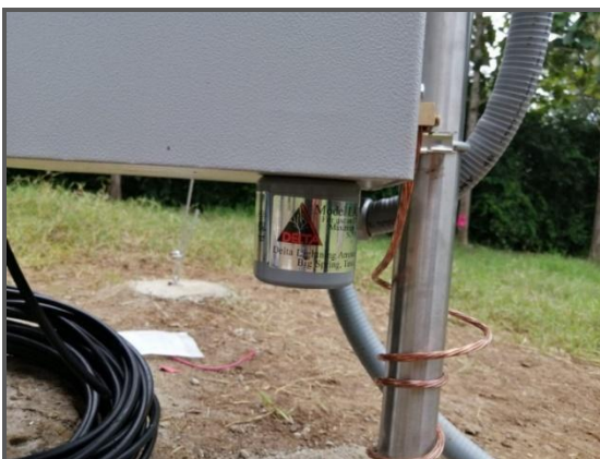
Figura 23. Instalación del supresor de picos para uso a la intemperie. Ilustración de trabajo conjunto SGC – IGAC.
