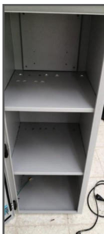
Figura 24. Preparación interna del Gabinete. Ilustración de trabajo conjunto SGC – IGAC
