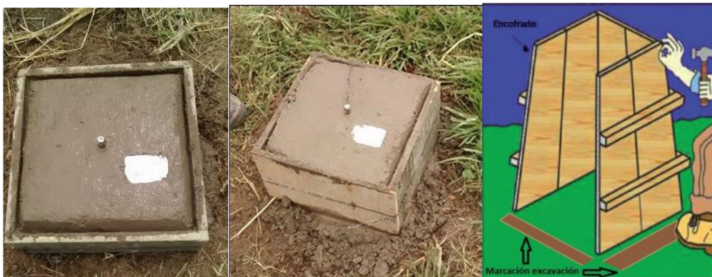
Figura 5. Armado de la formaleta y marcación de zona de excavación. Recuperado de: Elaboración propia.
